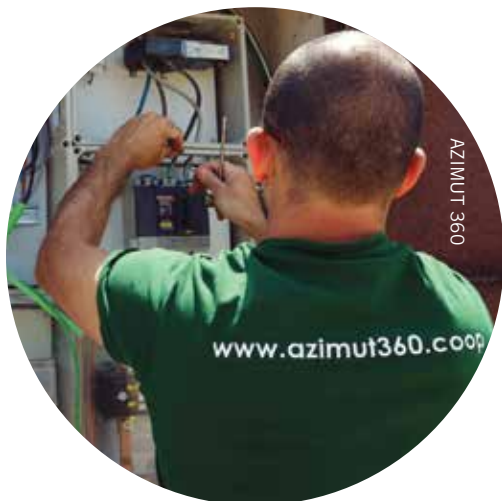
Instal·lació solar fotovoltaica de 3 kW per A autoconsum a l'Ajuntament de Viladamat (Girona).
